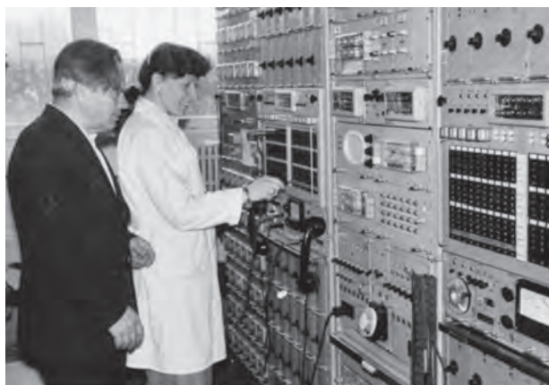
Проверка работы оборудования ЛАЦ
