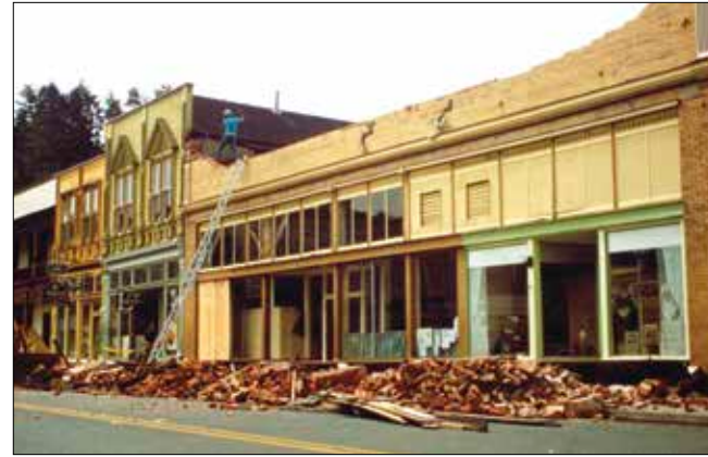
Los ladrillos del mismo edificio se cayeron durante el terremoto de abril de 1992. El edificio ha sido reemplazado por una estructura de madera.
