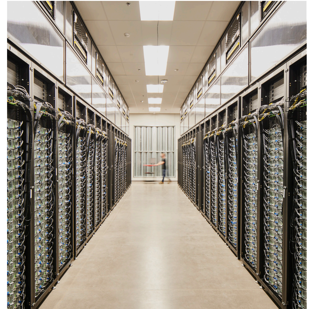
Das 2012 von Apple eröffnete Rechenzentrum in Reno profitiert vom milden Klima, indem es seine Server nach Möglichkeit mit Außenluft kühlt.
