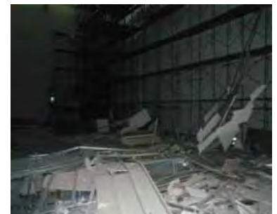
(図F) 宇宙ステーション試験棟 試験室の天井材料破損落下
