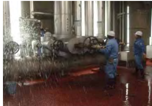
(図A) 動力棟 冷水・温水配管破損
