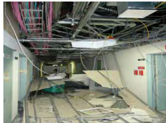
(図D) 宇宙ステーション運用棟 4階廊下電気ケーブルダクト・天井破損落下
