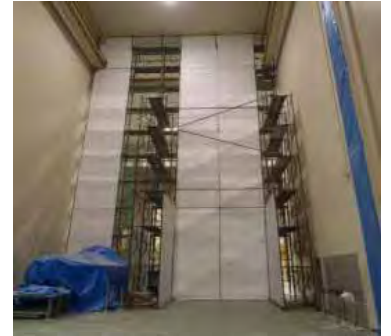
(図5) 総合環境試験棟 外部枠組み足場(仮設クリーンルーム外側)
