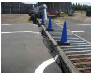
(図H) 構内道路の沈下
