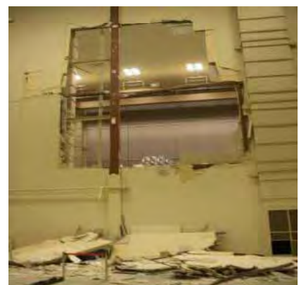
(図2) 総合環境試験棟被災状況 壁崩壊がれき
