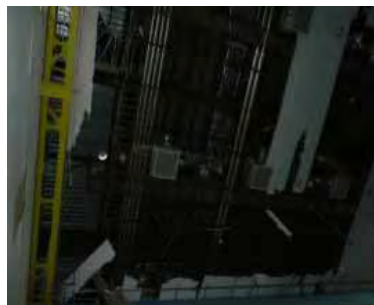
(図E) 宇宙ステーション試験棟 試験室の天井破損
