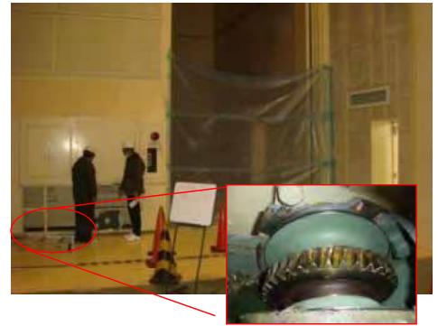
図4 音響設備 反響室扉駆動装置の破損(大扉2枚)
