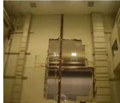
(図B) 総合環境試験棟 壁破損落下
