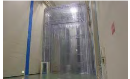
図5 音響設備前 クリーンテント設置による清浄度確保
