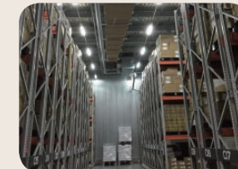
LED照明を用いた冷蔵庫内
