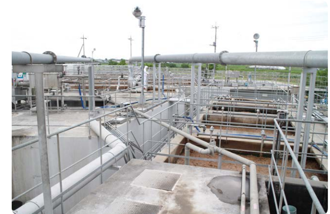
関東工場の浄化設備
