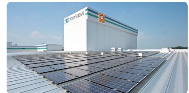
関東工場の太陽光発電パネル
