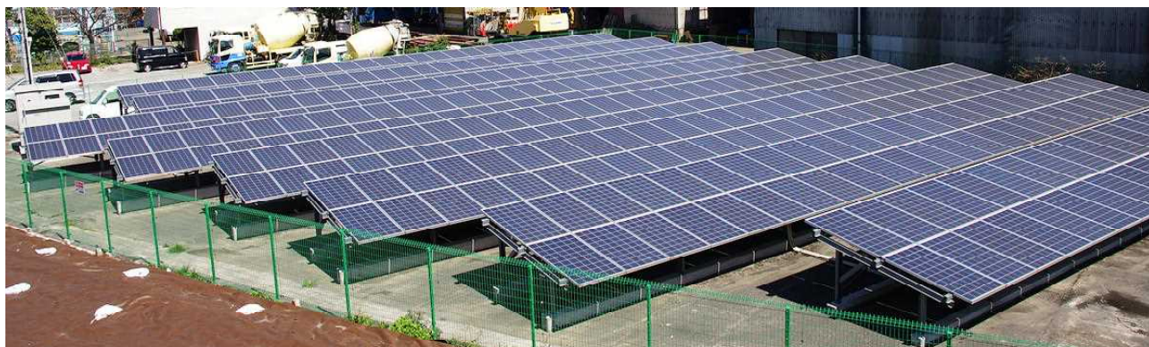
川崎市の一角で見た太陽光発電所
