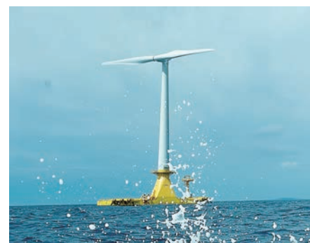
NEDO 次世代浮体式洋上風力発電システム「ひびき」(北九州市様ご提供)
