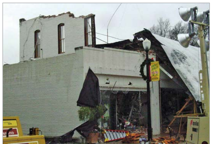
Un techo derrumbado en el centro de la ciudad de Paso Robles después del terremoto de San Simeon el 22 de diciembre de 2003. Dos personas resultaron muertas a causa de los escombros cuando salieron corriendo del edificio. (Foto USGS)
