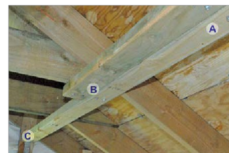
Figura 4-3. Nesta aplicação de contraventamento lateral, os 2x4 estão a 18 polegadas da cumeeira e se conectam aos membros horizontais que fixam as treliças opostas. Nem todos os telhados tem membros horizontais. Os 2x4s estão conectados com dois parafusos #14 de 3 polegadas (A) e superpostos em duas treliças (A e B). A extremidade é conectada à extremidade do frontão com um ângulo ou suporte em L (C). Imagem cortesia de Dennis Hwang.
