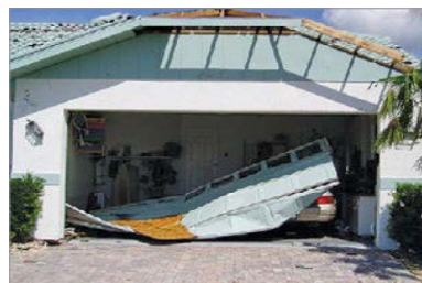
Figura 4-19. Devido à sua largura, portas de garagem dupla são mais suscetíveis a danos causados pelo vento do que as portas individuais. O vento pode forçá-las a sair do trilho, especialmente se o trilho for leve ou alguns dos parafusos de ancoragem não estiverem no lugar. Isso ocorre porque a porta falha sob pressão excessiva do vento. Imagem cortesia de Florida Hurricane Depot.
