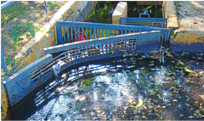
Trampa de sólidos en empacadora. Foto Miguel Vallejo
