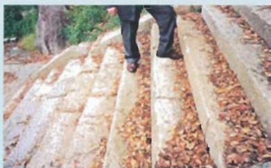
祭礼が開催される神社階段の一段ごとの状況（亀裂等）を確認
