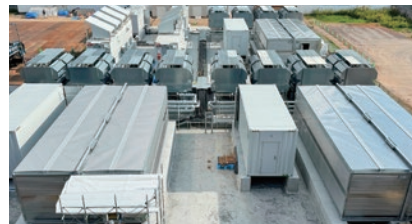
石狩データセンターに構築中のコンテナ型データセンター
