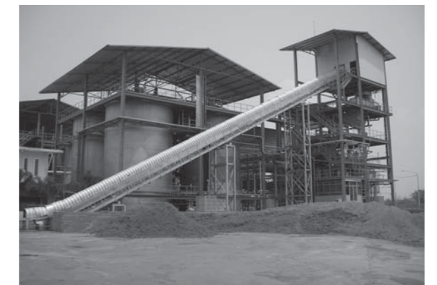
図6 バガスエタノール設備 Fig.6 Bagasse ethanol plant
