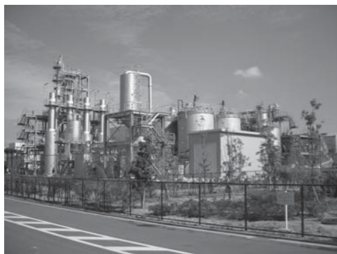
図1 世界初の木質系バイオエタノール商業設備 (バイオエタノール・ジャパン・関西株式会社) Fig.1 The first commercial plant for bioethanol production from lignocellulosic biomass
