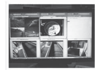
図9 監視室のモニタによる監視 Fig.9 Monitoring screen from cameras
