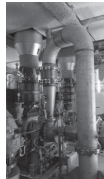
図3 葛西水再生センター焼却設備の外観写真①
