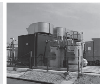
図3 鹿沼市黒川消化ガス発電所 Fig.3 Kurokawa digestion gas power plant
