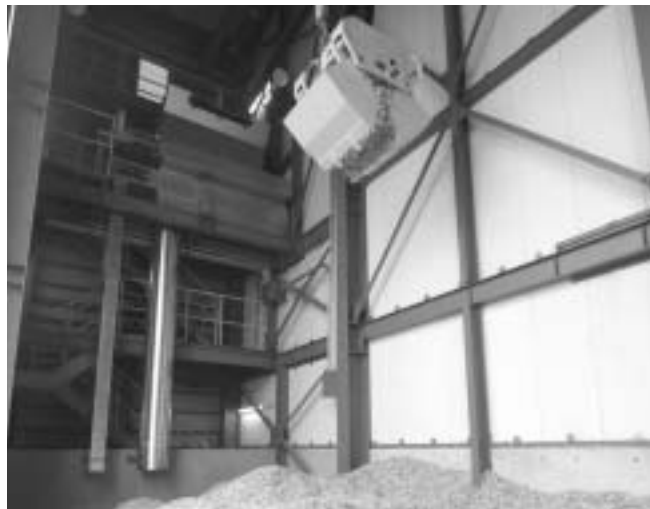
図3 原料ヤードとクレーン Fig.3 Stockyard and crane
