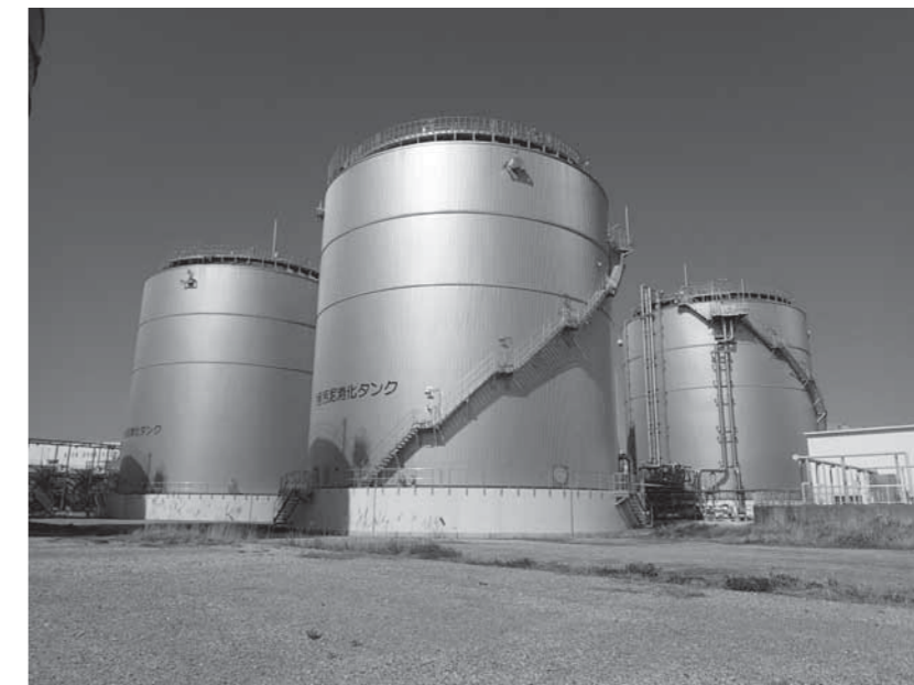
図1 汚泥消化タンク(下部コーン型鋼板製消化タンク)の写真 Fig.1 The picture of sludge digestion tank (Steel-plate sludge digestion tank).
