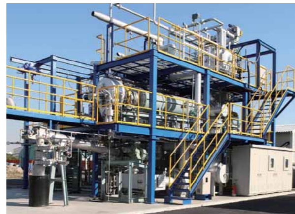
図1 実証プラント
