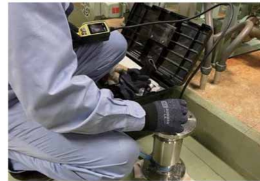
図5 ノズル内部確認 Fig.5 Check inside the nozzle
