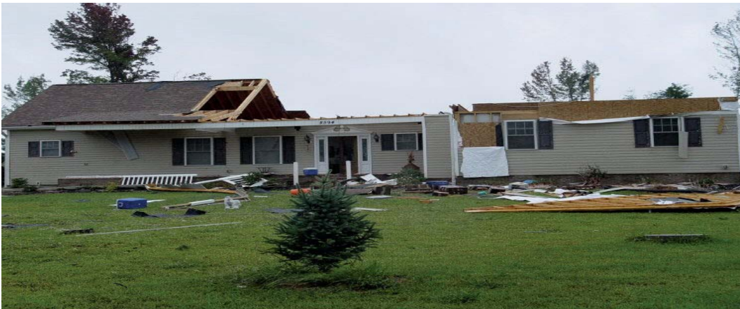
El daño de un tornado en Stokesdale, Carolina el Norte, y una ráfaga de una fuerte corriente descendente de 79mph/127km/h en el Aeropuerto Internacional de Raleigh-Durham durante el paso de los restantes del huracán Iván el 17 de septiembre de 2004, Administración de Emergencias del Condado de Guilford, el Departamento de Bomberos de Stokesdale, Doug Schneider, Darin Figurskey y Jeff Orrock.
