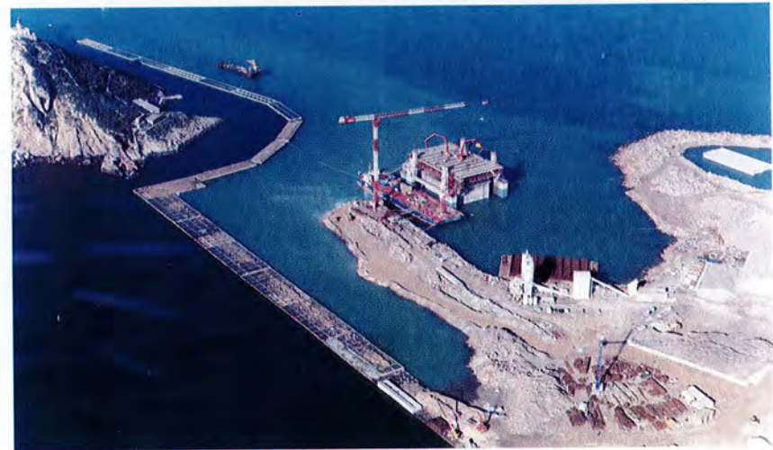
El dique sur completado y se observa el dique perimetral que rodea la isla de Escombreras. En el centro, la cajonera en proceso de construcción de uno de los cajones
