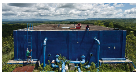
Von einem Hochspeicher aus wird das Wasser in die umliegenden Täler und Dörfer transportiert. (Foto: IWG)
