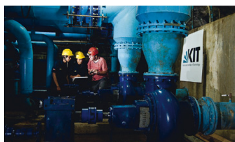
Wasser für Gunung Sewu: In einer unterirdischen Höhle staut ein Wasserkraftwerk das zuströmende Wasser auf und fördert es an die Oberfläche. (Foto: IWG)
